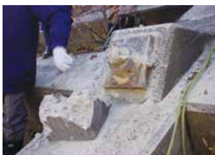
旧タイプアンカーの頭部状況
