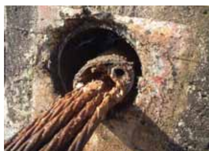
③頭部背面調査 (著しい腐食)
